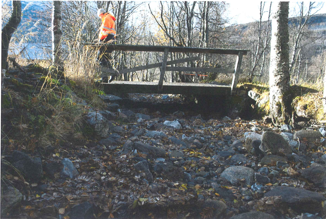
Figur 16: Elveløpet er oppfylt av masser ved brua til gården. Bildet er orientert mot SV.
